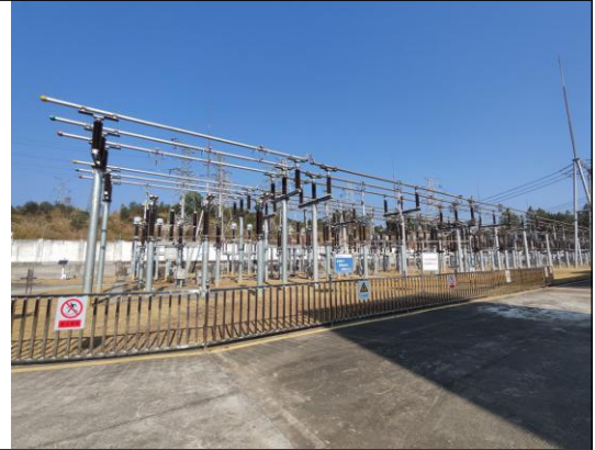
110KV 配电装置
