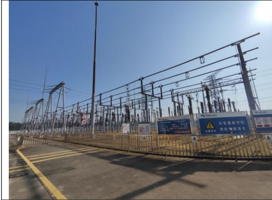
220KV 配电装置
